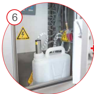
6 Αποθήκευση χημικών σε δοχείο κλειδωμένο μέσα στη μονάδα
